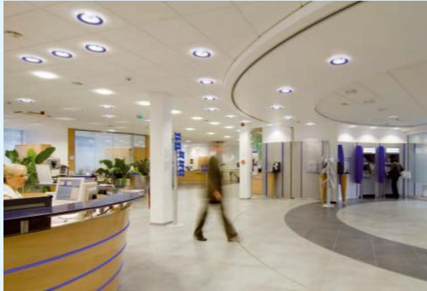
Der Schalteraum wird mit dem VRV III-System gekühlt und geheizt.
