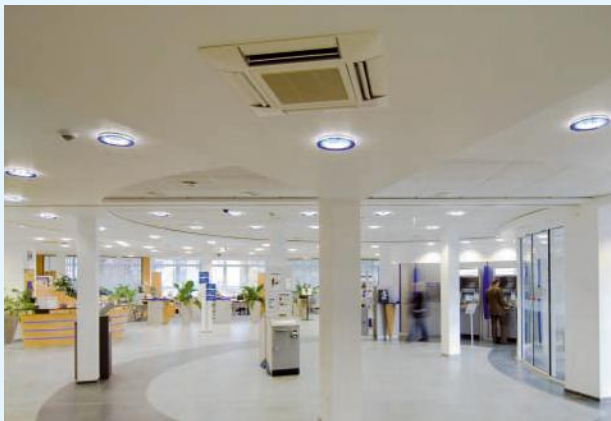
Durch Computer und Licht erhöht sich die Wärmelast erheblich.
