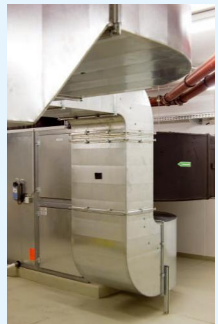
Die VRV ist ins bestehende Lüftungssystem integriert.
